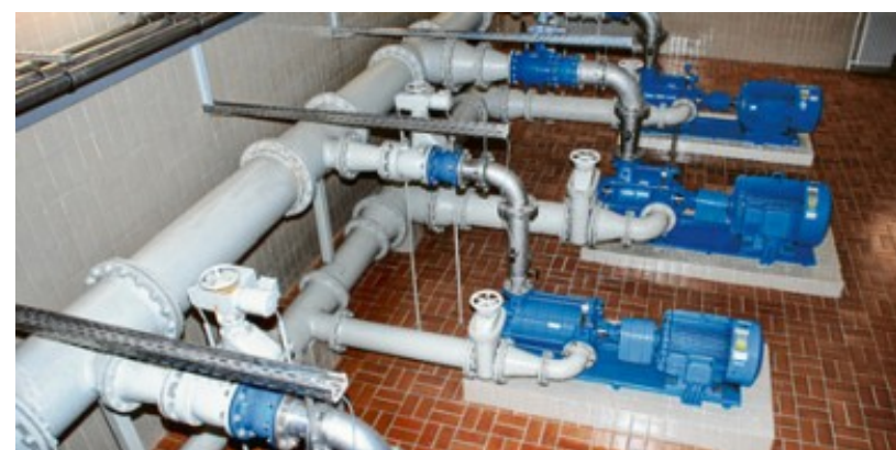
Das Herzstück des Wasserwerkes ist der Maschinenraum mit vier Hochleistungspumpen.
